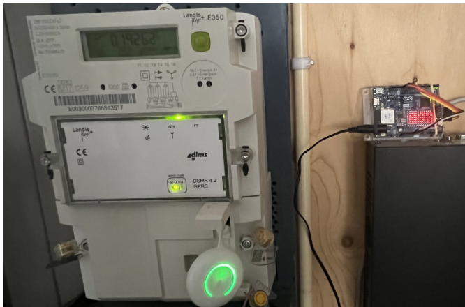
P1-meter (met groene cirkel) in de P1-poort (onder het klepje) van de slimme meter in het clubhuis
